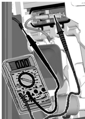
Messung des Ionisationsstromes Bild 10.3.g
